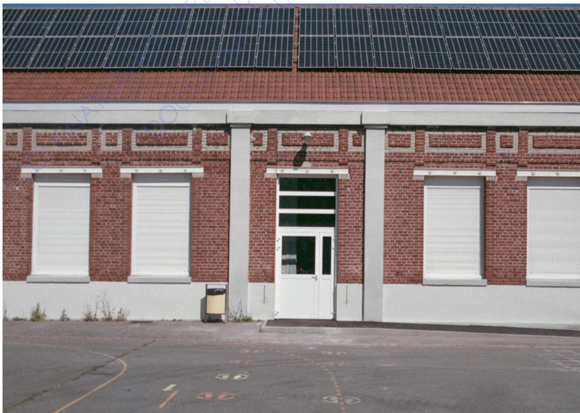
Couverture photovoltaïque de l'école Basly, juillet 2020.
